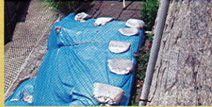
⑮ 道路陥没通行止め
