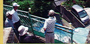
⑯ 道路陥没通行止め
